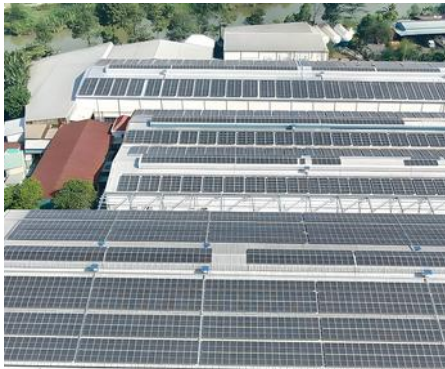
Metal-roof array – industrial rooftop ផ្ទាំងលើ ដំបូលដែក – ដំបូលឧស្សាហកម្ម
