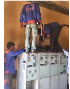
RMU installed by TTP
