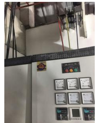
Metering & instrument panel ទូរវាស់ស្ទង់
