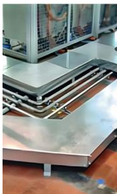
Cable ladder installed ជណ្តើរខ្សែបានតម្លើង
