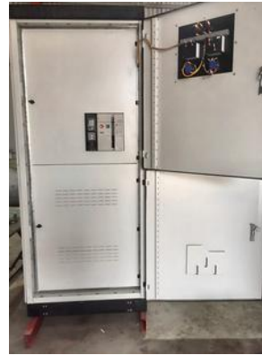
ACB panel – withdrawable breaker ទូរ ACB – ឧបករណ៍ផ្តាច់ទាញចេញបាន
