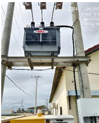
320 kVA · Chongruk 320 kVA · Chongruk
