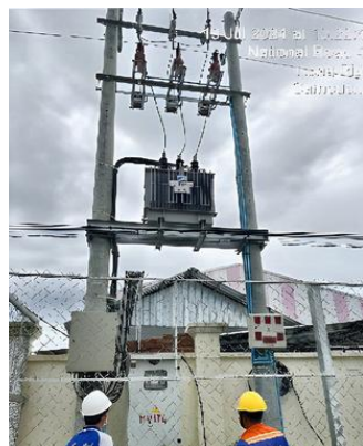
400 kVA · NR41 – Kong Pisei 400 kVA · NR41 – Kong Pisei
