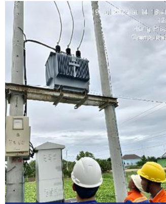
250 kVA · Kong Pisei 250 kVA · Kong Pisei
