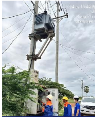
160 kVA · Kong Pisei 160 kVA · Kong Pisei
