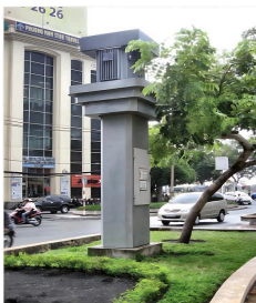
One-pillar substation ស្ថានីយលើសសរតែមួយ
