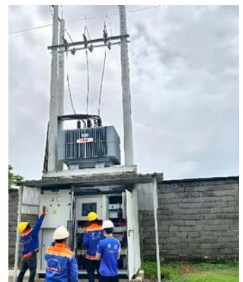
1,600 kVA · Svay Kravan 1,600 kVA · Svay Kravan
