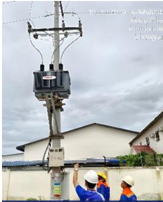
160 kVA · Chongruk 160 kVA · Chongruk
