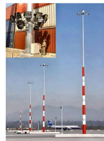
High-mast poles សរសៃភ្លើងខ្ពស់
