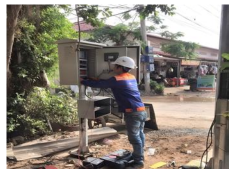
NR6 – controller wiring ផ្លូវជាតិលេខ 6 – ភ្ជាប់ ខ្សែទូបញ្ជា
