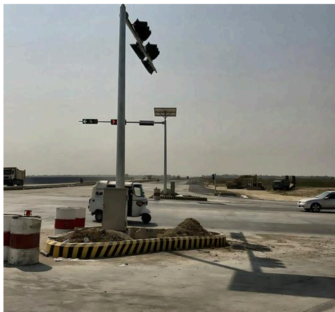
Solar traffic signal – airport access road, Kandal (2024) ភ្លើងចរាចរណ៍សូឡា – ផ្លូវចូលព្រលានយន្តហោះ កណ្តាល (2024)
