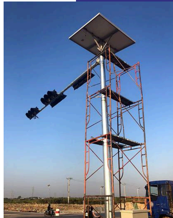
ទម្រង់ឆ្លើងសញ្ញាចរាចរណ៍ Traffic light posts
